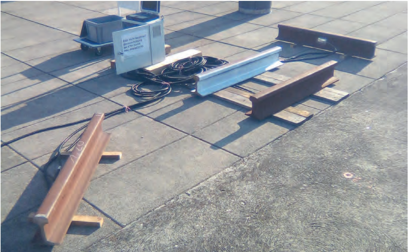
Abb. 2: Aufbau Schientemperaturmessungen (v. l. n. r. SSO, SSW, OSO) [2]
