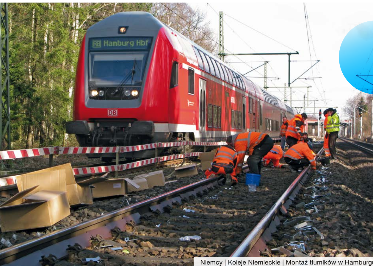
Montaż tłumików Calmmoon Rail na zmianie nocnej, po wyłączeniu toru z ruchu
