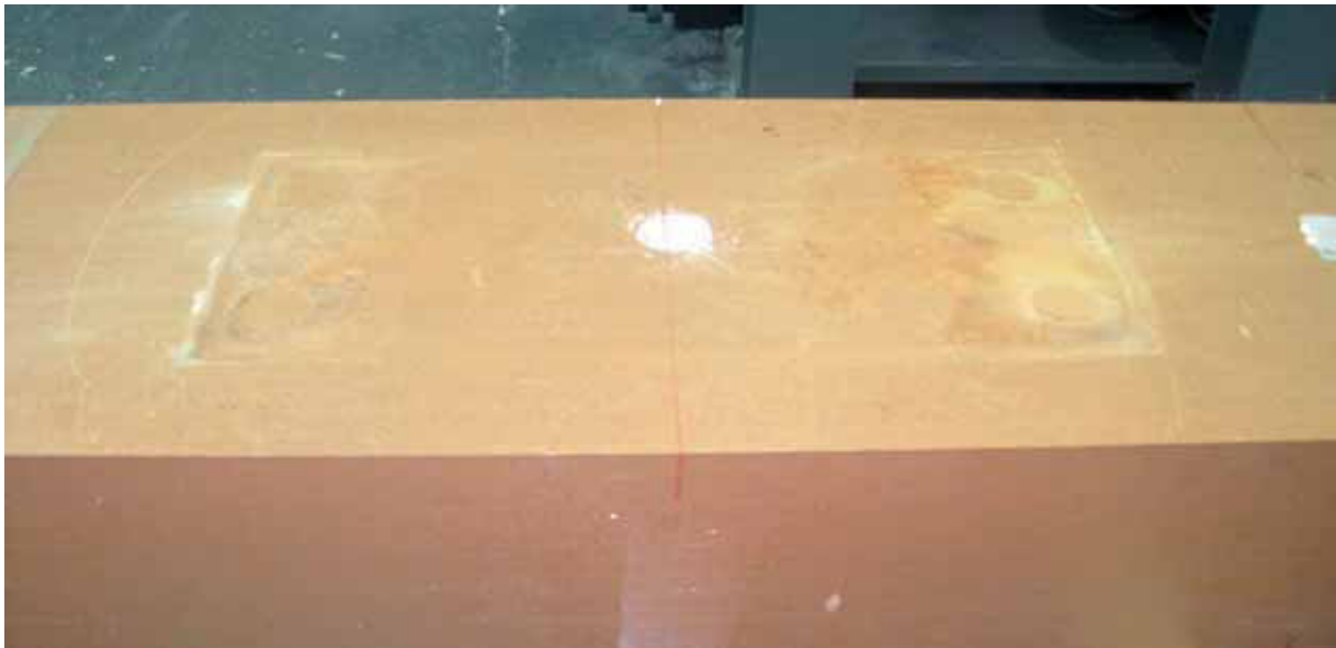
Unter den Schienenauflagern konnten nur geringfügige plastische Verformungen festgestellt werden
